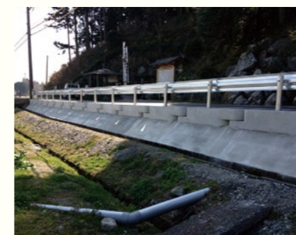
損斐土木事務所(岐阜県)
